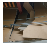
보관실 벽체 파손
